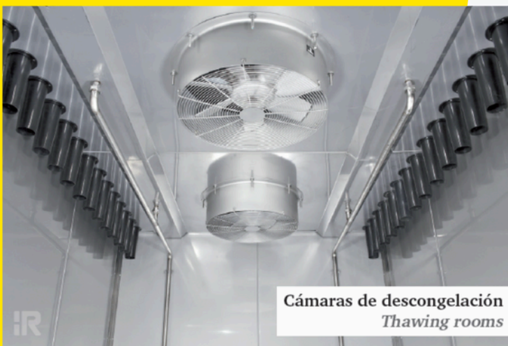
Câmara de descongelamento
